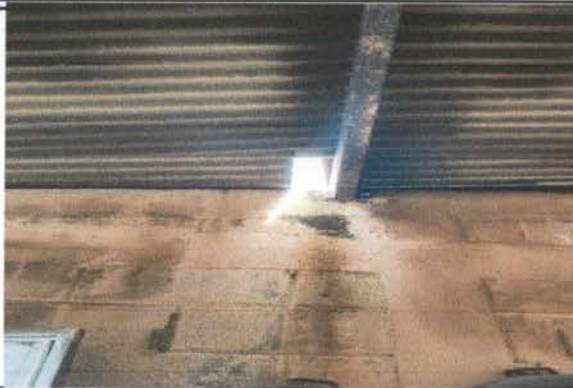
Foto1: Techo de cocina mal estado
