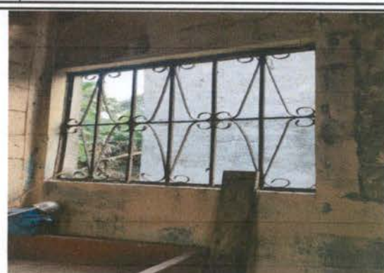
Foto 2: ventanales mal estado
