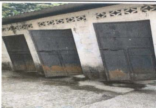
Foto 3: Puertas de Sanitarios en mal estado
