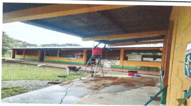
Foto 5: CANALES Y BAJADA DE AGUA PLUVIAL
