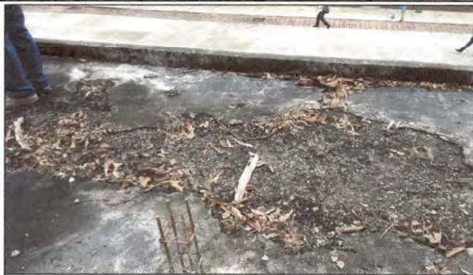
Foto 7: Estado actual de losa del techo de todo el establecimiento, se solicitan trabajos de remozamiento en esta área debido a su estado tan grave de deterioro.
