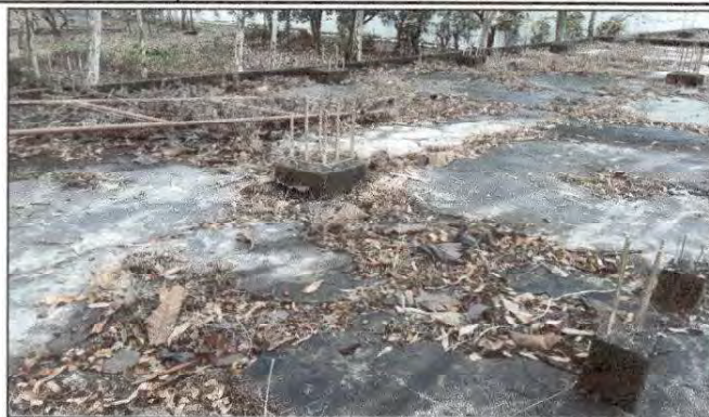
Foto 8: Estado actual de losa del techo de todo el establecimiento, se solicitan trabajos de remozamiento en esta área debido a su estado tan grave de deterioro.
