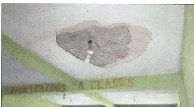
Foto 12: Debido al estado de deterioro de la losa del techo, las instalaciones del establecimiento se han visto afectadas, solicitan el remozamiento de dicha losa.
