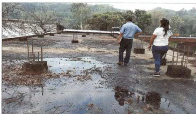
Foto 10: Debido al estado tan grave de deterioro en el que se encuentra la losa del techo, solicitan trabajos de remozamiento en esta área.
