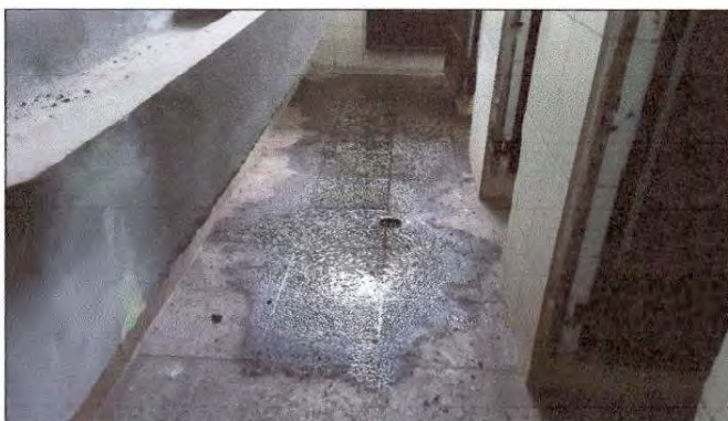
Foto 3: Estado actual de los servicios sanitarios, solicitan trabajos de remozamiento en dicha área.
