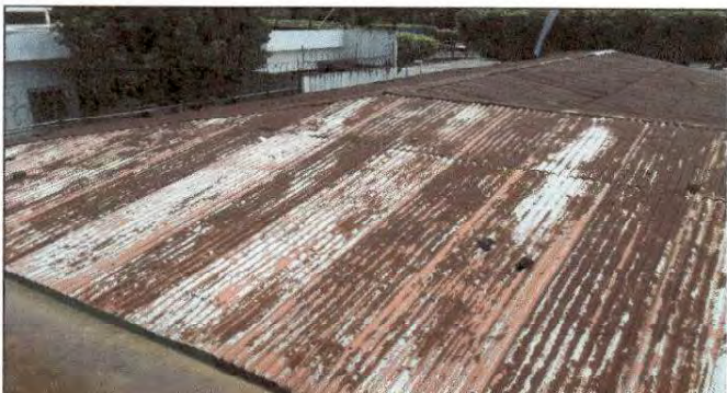
Foto 5: Estado actual de la cubierta de lámina en módulo de aulas, solicitan el cambio de dicha cubierta debido a su estado de deterioro.
