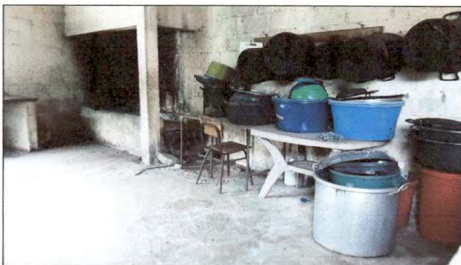
Foto 3: Estado actual del área de cocina, solicitan trabajos de mejoramiento en dicha área. Entre los trabajos solicitados están la colocación de piso y azulejos.
