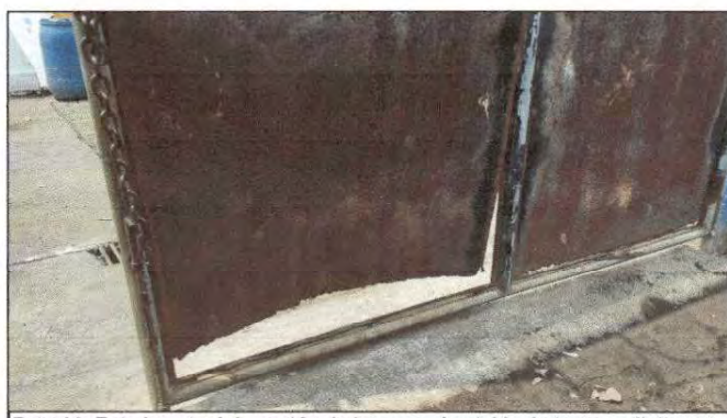
Foto 11: Estado actual de portón de ingreso al establecimiento, solicitan el cambio de este mismo para el mejoramiento de la seguridad.
