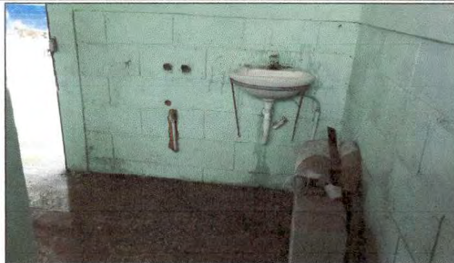
Foto 8: Estado actual de los servicios sanitarios de niños y niñas, solicitan trabajos de reparación y mantenimiento ya que algunos inodoros y lavamanos se encuentran inhabilitados.
