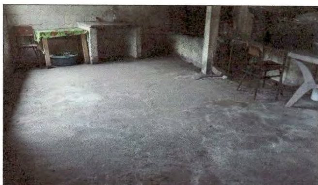
Foto 4: Estado actual del área de cocina, solicitan trabajos de mejoramiento en dicha área. Entre los trabajos solicitados están la colocación de piso y azulejos.
