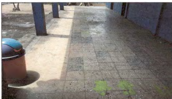
Foto 9: Debido al estado de deterioro del piso, solicitan el cambio de este mismo en módulo de aulas y pasillo.
