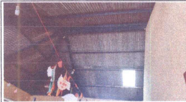
Foto 3: La estructura de madera esta con polia y se pretende el cambio a costanera o tubo cuadrado galvanizado
