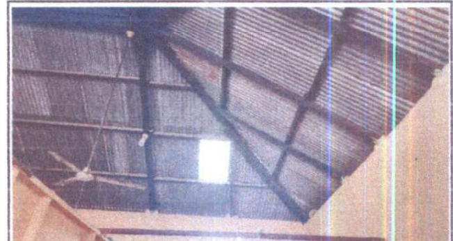
Foto 4: La lamina tiene corrosion en su parte superior se pretende el cambio a lamina galvanizada
