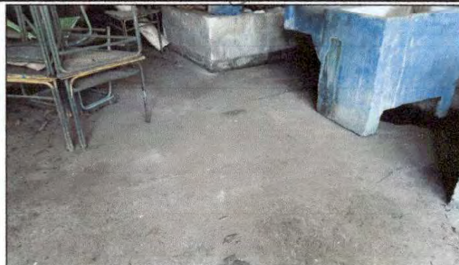
Foto 8: Estado actual del área de cocina. Solicitan la colocación de piso cerámico antideslizante para mejorar las condiciones de trabajo en esta área.
