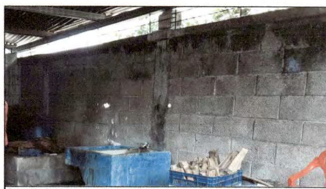
Foto 12: Debido a las altas temperaturas que se alcanzan en el área de cocina, se solicita la colocación de balcones para mejorar la ventilación.
