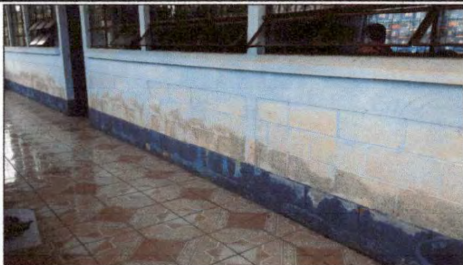
Foto 7: Se solicita la aplicación de pintura en muros del establecimiento, ya que esta se encuentra desgastada.
