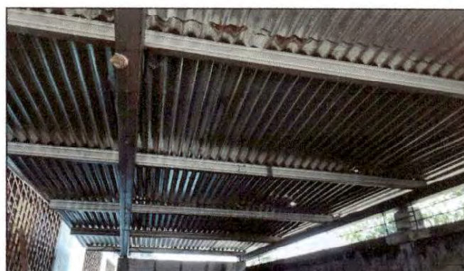
Foto 10: Solicitan el cambio de la cubierta de lámina en el área de cocina debido al estado de deterioro en el que se encuentra.
