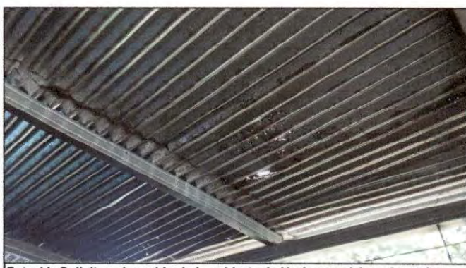
Foto 11: Solicitan el cambio de la cubierta de lámina en el área de cocina debido al estado de deterioro en el que se encuentra.
