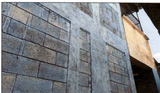
Foto 10: Debido al desgaste de la pintura por el paso del tiempo, se solicita la aplicación de pintura en muros del establecimiento.
