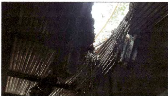
Foto 9: Solicitan el cambio de la cubierta de lámina, ya que su estado actual ha dejado inhabilitada la bodega.
