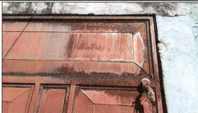
Foto 7: Estado actual de la puerta de acceso a la bodega, solicitando el cambio de esta misma ya que se encuentra en un estado muy deteriorado.
