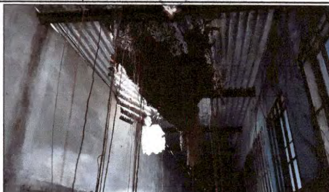
Foto 8: Solicitan el cambio de la cubierta de lámina, ya que su estado actual ha dejado inhabilitada la bodega.
