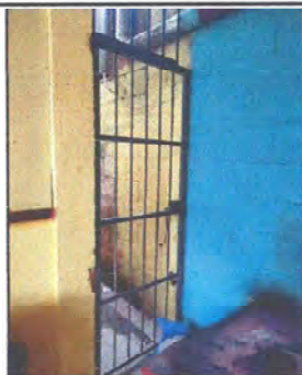
Foto 1: Puerta de reja que necesita forrarse para evitar que ingrese contaminación a la cocina.
