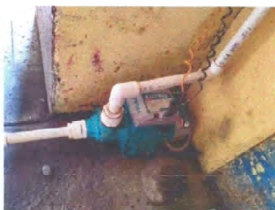
Foto 11: La bomba de agua ya no funciona.
