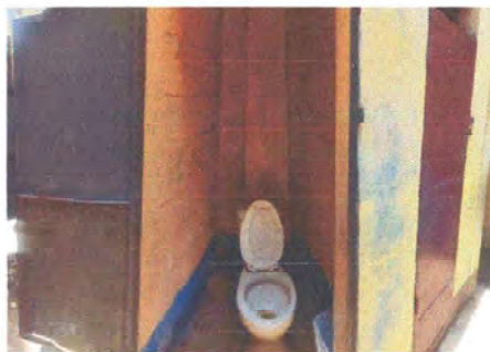
Foto 8: Se necesita pintura en paredes y puertas.
