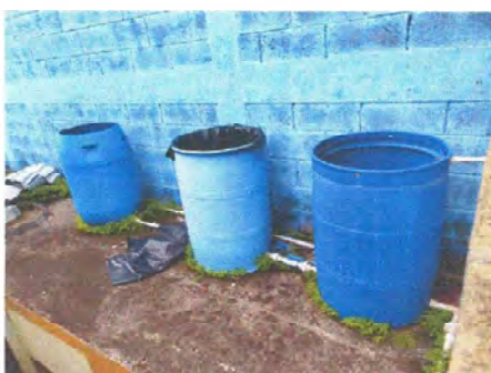
Foto 9: Depósitos de agua sobre losa de sanitarios ya no son funcionales y no tienen tapadera, se utiliza nylon para taparlos.
