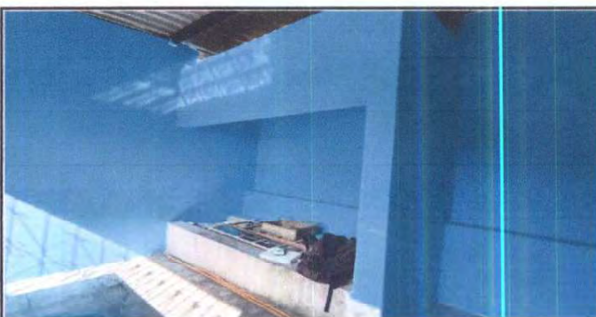
Foto 6: Pintura en muros interiores de cocina
