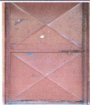
Foto 2: Sustrucción puerta grande aula formal
