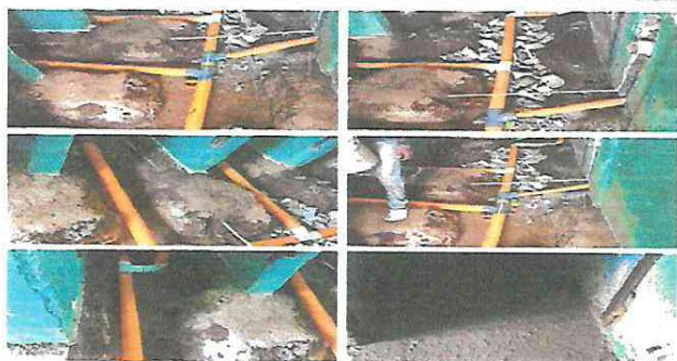
Foto 13: trabajos de socavamiento
