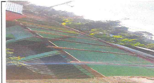
Foto 4 Desmantelación de láminas en aulas. Croquis 4
