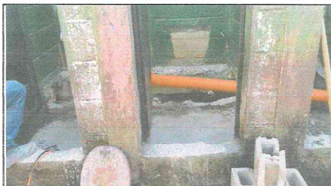
Foto 4: Tubería para drenaje de aguas negras en sanitarios
