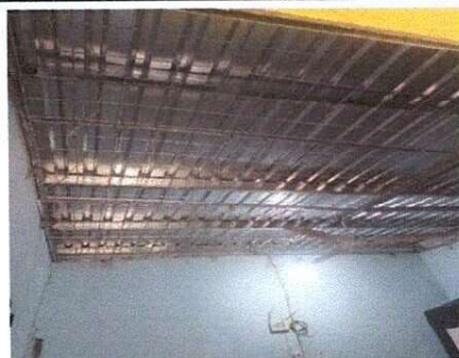
Foto 2: Sustrucción de lamina toquelada
