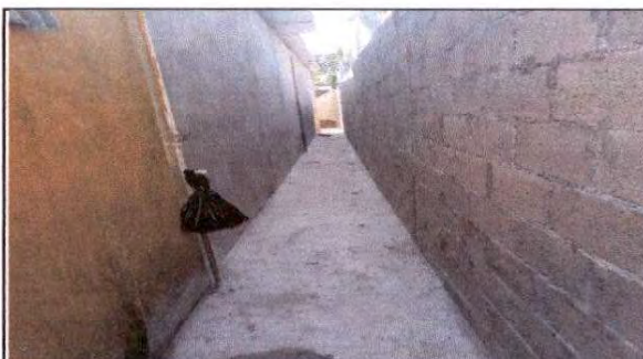
Foto 4: Repello en muro exterior trasero
