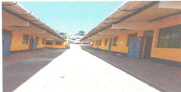
Foto 2: torta de cemento en el corredor de adentro
