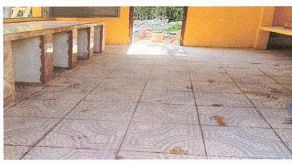
Foto 4: Piso cerámico en cocina.
