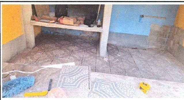
Foto 4: Piso cerámico en cocina.
