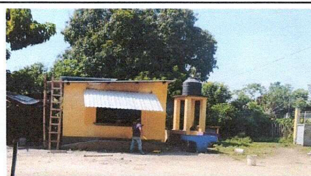
Foto 3: Pinturas en muros exteriores e interiores de cocina.
