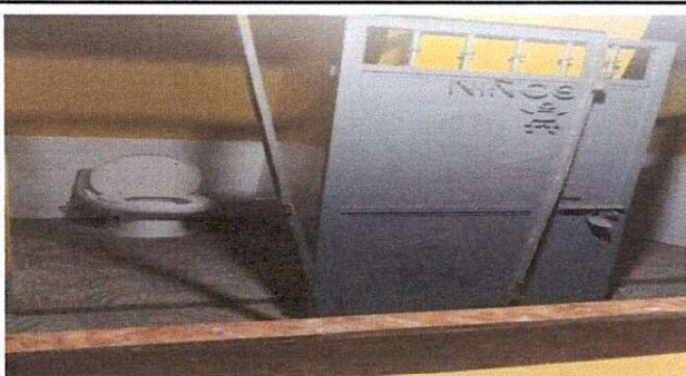
Foto 5: Puertas de metal en sanitarios.
