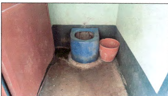
Foto 6: Debido a la antigüedad de los servicios sanitarios, se solicita la modernización de estos mismos.
