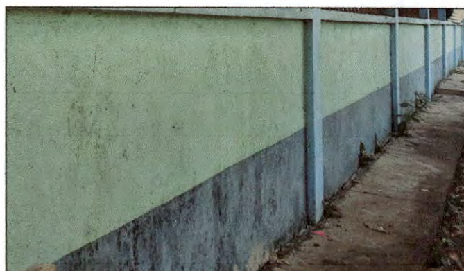
Foto 10: Estado actual de la pintura en muros del establecimiento, solicitan la aplicación de pintura debido al desgaste en el que se encuentra.
