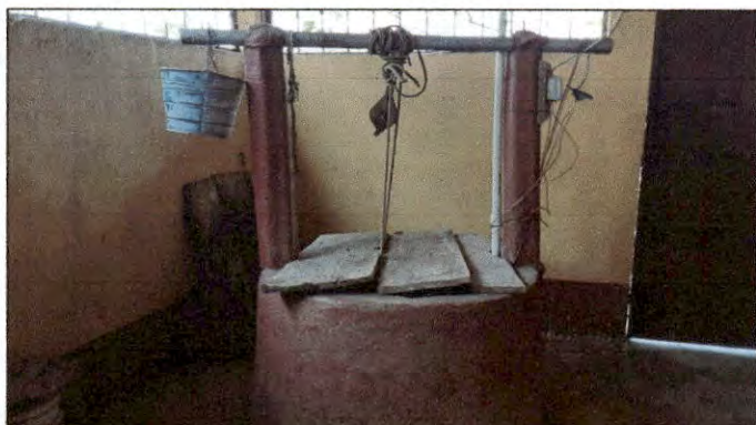
Foto 3: Estado actual de pozo de agua, solicitan el mejoramiento de este mismo ya que es el único método que tiene el establecimiento de obtener agua.
