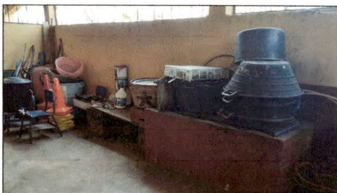
Foto 4: Estado actual del área de cocina, solicitan el traslado de dicha área a otro espacio que el establecimiento tiene disponible.
