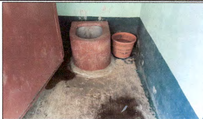
Foto 8: Para mejorar la higiene y limpieza en los servicios sanitarios, solicitan su mejoramiento con la colocación de piso y azulejos.
