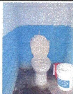
Foto 4: MODULO III, SERVICIOS SANITARIOS Y SUS ACCESORIOS
