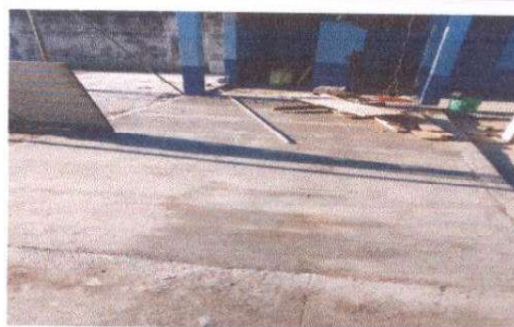
Losa de patio de concreto frente a sanitarios
