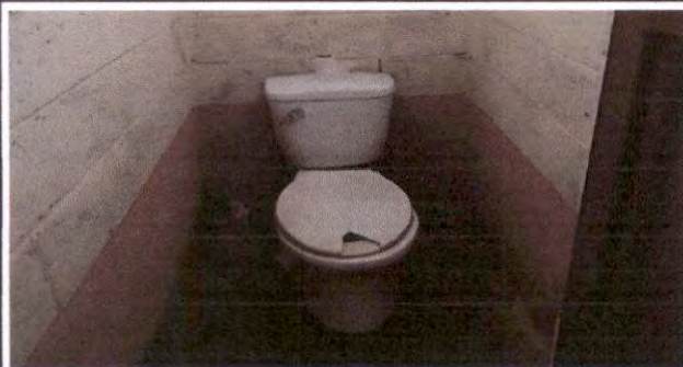
Sanitario en mal estado
