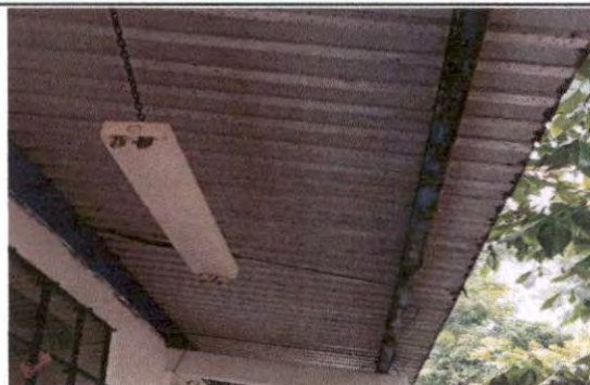
Cambio de lámina por picadura y oxidación
