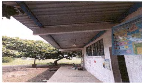
Sistema electrico, cambio de lamparas
