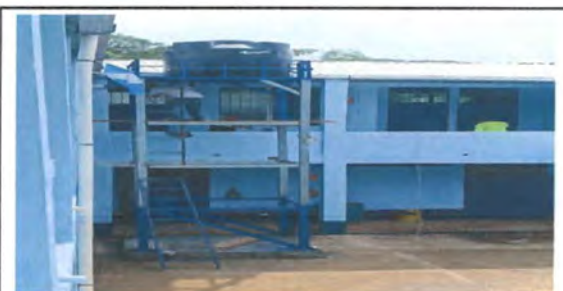
Foto 6: pintura en general
