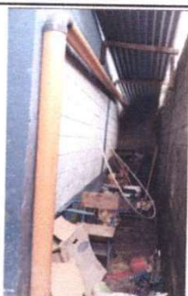
Foto 3: CANALES Y BAJAS DE AGUA PLUVIAL A LA PAR DEL AULA DE 1RO B
