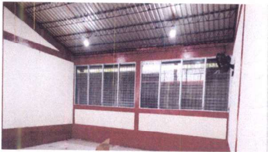
Foto 3: PINTURA INTERIOR DE AULAS
