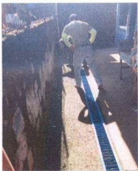
Foto 3: Suministro de rejilla
