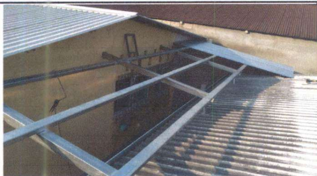
Foto1: Techo de lámina enfrente de baño
