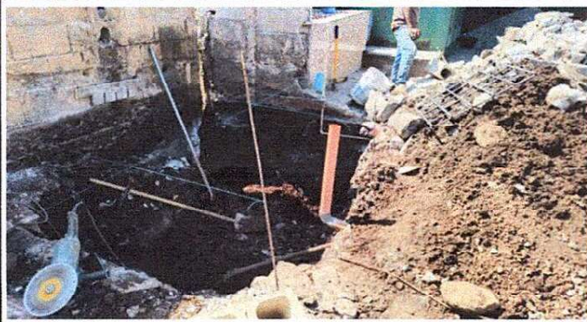
Foto1: Mantenimiento area de baños, por socavamiento
