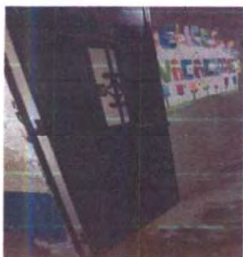
Foto 3: Cambio de puerta incluye chapa.
