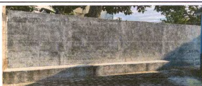
Foto 30: Repello y cernido en muro
