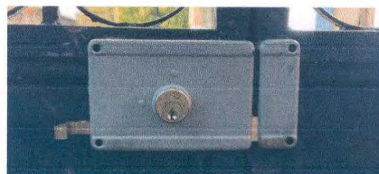
Foto 4: Cambio de Chapa en puerta principal (no funciona bien).
