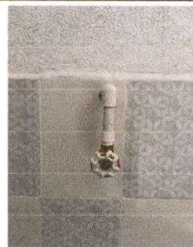
Foto 14: Sustrucción llave en mingitorio
