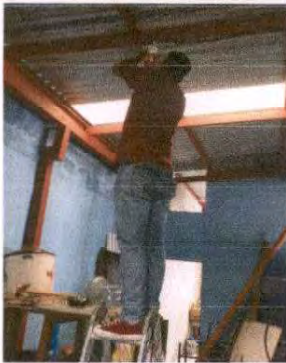
Foto 25: Sustitución focos ahorradores
