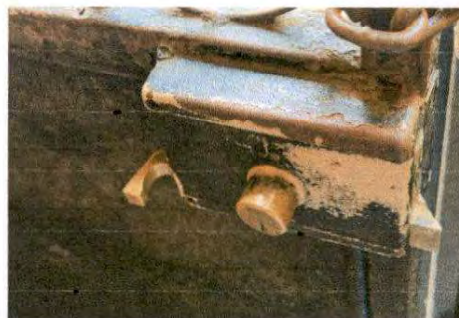
Foto 4: Cambio de Chapa en puerta principal (no funciona bien).
