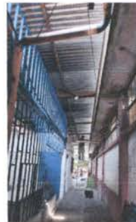
Foto 8: Instalación eléctrica en pasillo de dirección
