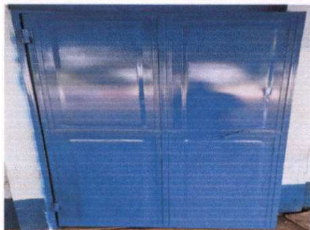
PUERTA A SUSTITUIR
