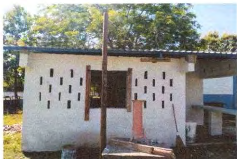
Foto 7: Sustrucción de ventana de madera por metal
