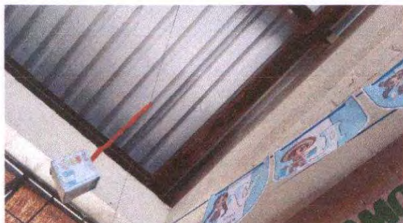
Foto 17: Módulo I. Filtración de agua salón 1.
