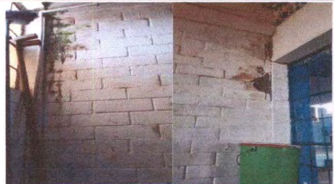
Foto 22: Módulo III. Filtración de agua salón 4.
