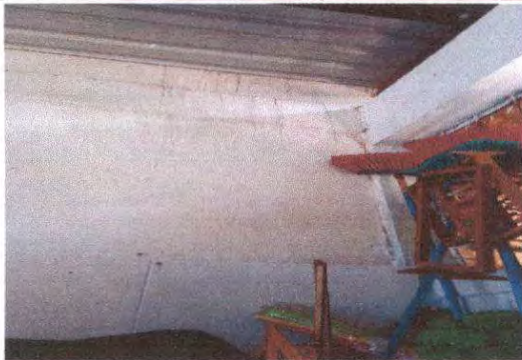
Foto 21: Módulo III. Filtración de agua salón 1.
