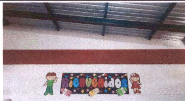
Foto 18: Módulo I. Filtración de agua salón 4.
