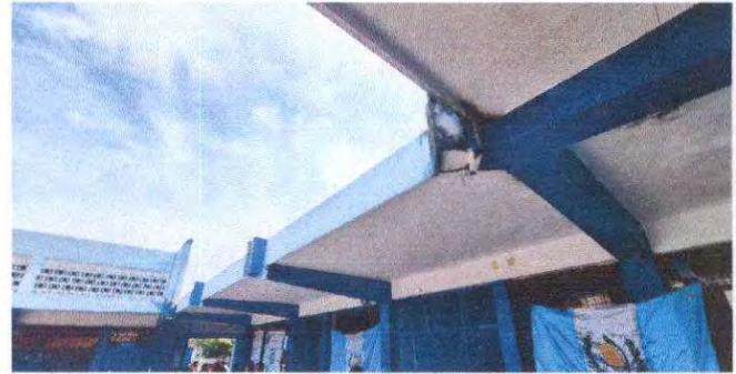
Foto 20: Módulo II. Filtración de agua en corredor.
