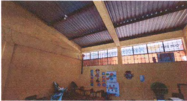
Foto 19: Módulo II: Filtración de agua salón 1.
