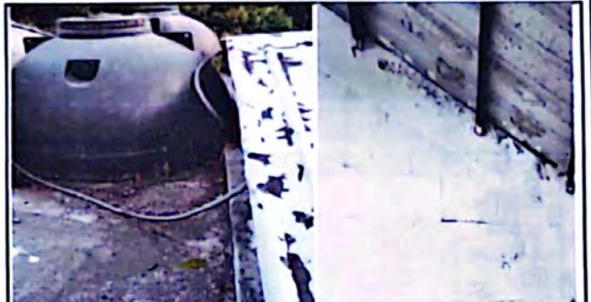
Foto 8: losa en mal estado.
