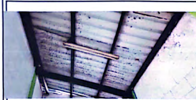
Foto 7: cubierto de láminas deterioradas.
