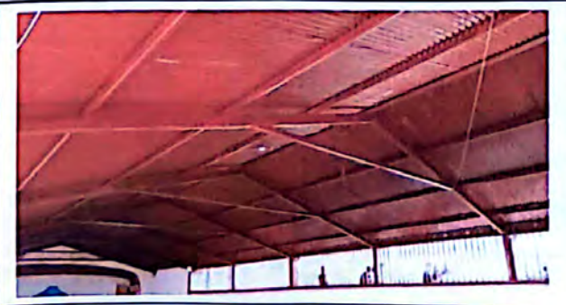
Foto 5: Falta de lamparas en el salon de usos multiples
