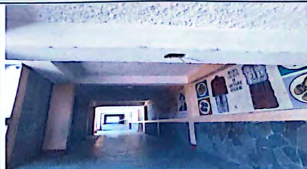
Foto 2: Falta de plafonera en los corredores
