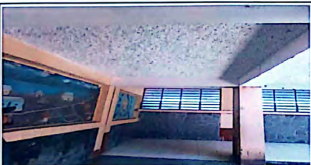
Foto 3: falta de instalacion del pasillo
