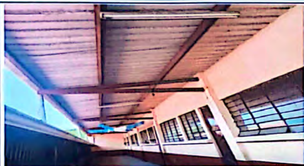
Foto 1: Deterioro de las lamaparas en corredores
