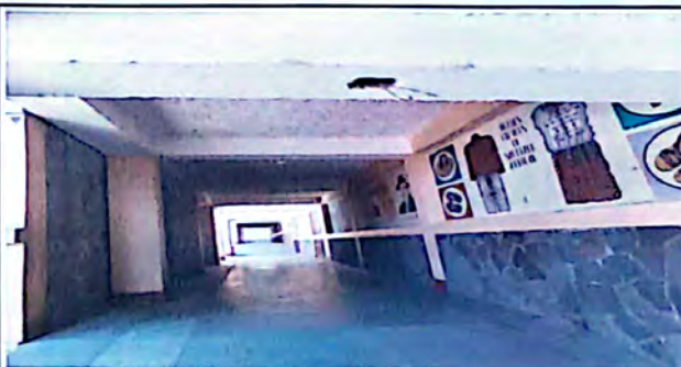
Foto 4: Falta de lamparas en el pasillo
