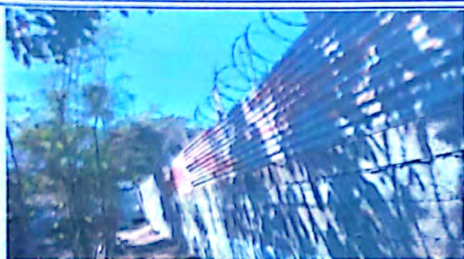
Foto 1: Se observa la falta de muro perimetral en la escuela.
