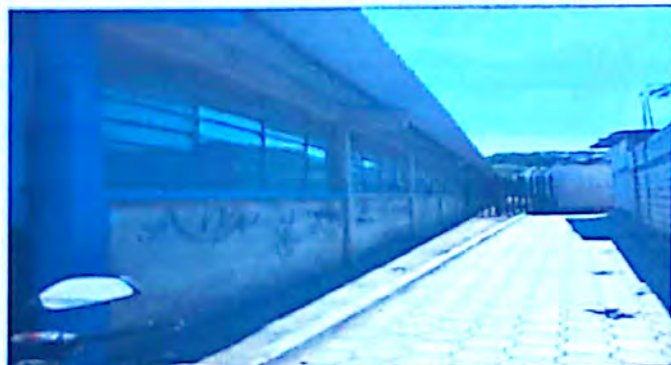
Foto 3: Se observa una parte de la escuela que necesita de planchas de metal, para circularlo por completo.
