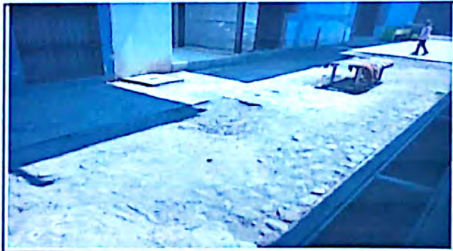
Foto 4: Falta losa de patio en la escuela enfrente de la sala de computación.
