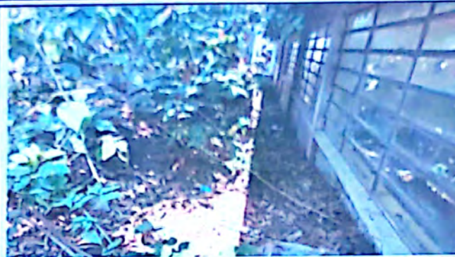
Foto 2: se observa atrás de una de las aulas, que necesita de planchas de metal para circular la establecimiento.
