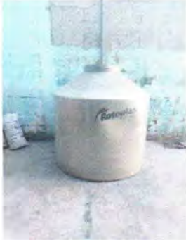
Foto 7. Depósito de agua nuevo
