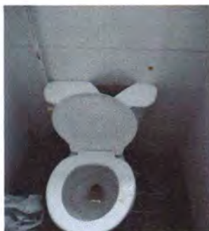
Foto 3. Sustituir 2 inodoros que ya están deteriorados
