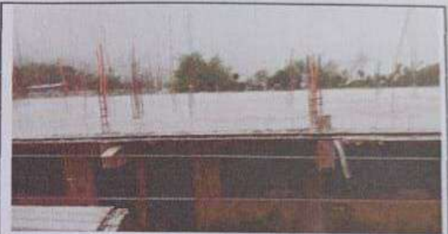
Foto 4: Techo del aula No 1.
