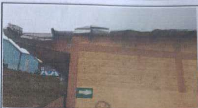
Foto 4: En esta imagen se puede observar las láminas deterioradas por las inclemencias del tiempo.
