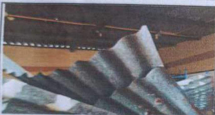
Foto 3: en esta otra aula se puede apreciar que también las láminas están deterioradas y rotas.
