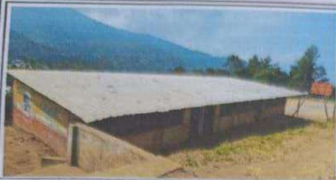
Foto 1: El techado de las aulas se encuentran deterioradas por su uso natural y por las inclemencias del tiempo.
