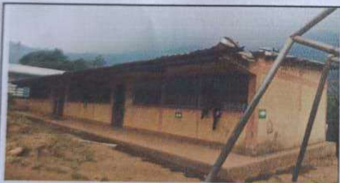
Foto 5: Las láminas se encuentran fuera de las costaneras.
