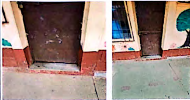
Foto1: Se muestra las puertas de aulas en mal estado.
