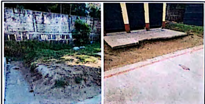
Foto 6: Tambien el pavimento de patio necesita reconstruir.
