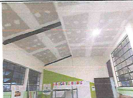
FOTO 2: Se está avanzando con el trabajo, aquí se observa que ya arreglaron una iluminación pero falta otra.
