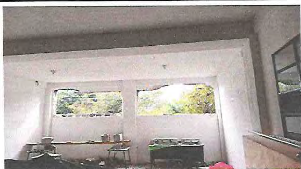
Foto 3: Apertura de dos ventanas en interior del salon de preprimaria por falta de luz natural.
