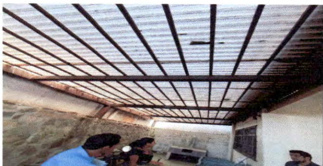
Foto 9: LAMINA CON AGUJEROS GRANDES Y EN MUY MAL ESTADO
