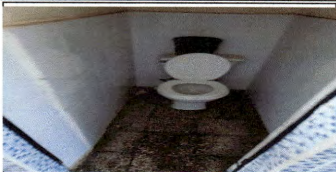
Foto 7: FALTA DE ACCESORIOS EN INODOROS
