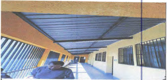
Foto 12: FALTA DE LAMPARAS EN PASILLOS
