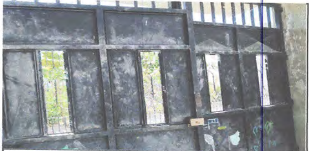
Foto 10: PORTON OXIDADO Y RAYADO
