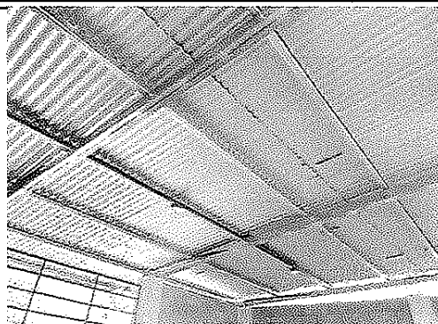
Foto 2: Techo que tenía filtración de agua, ya cambiada
