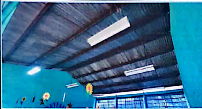
Foto 1: Cable y focos de energía eléctrica en mal estado
