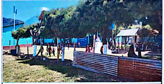
Foto 2: Circulación del establecimiento provisional y en mal estado.
