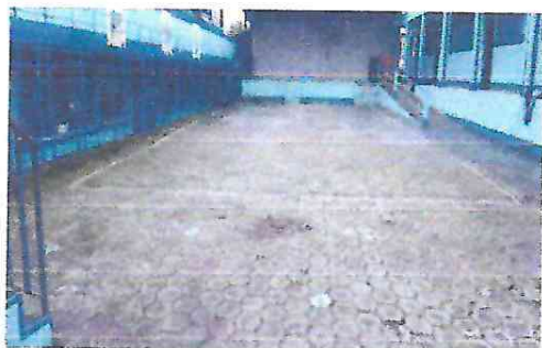
MAL ESTADO DEL PATIO
